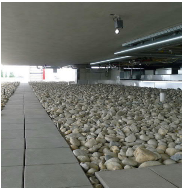
Blick auf die Technik unter dem Helideck
