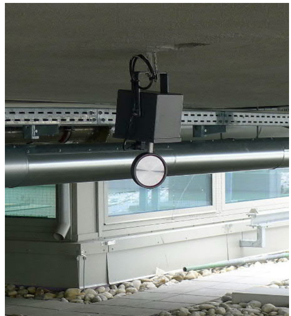
Ornigard-Gerät, von der Decke abgehängt
