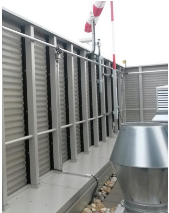
Rückkühlwerk: Ansicht von Innen
