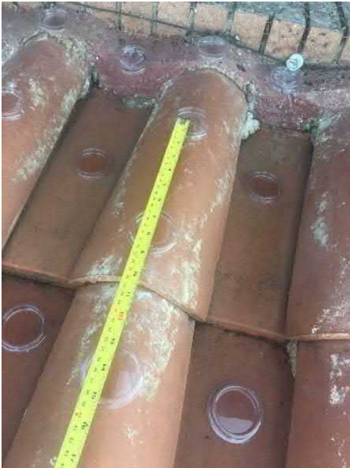
Bild 9. Nord-Dach mit installierten leeren PET Schälchen “zur Kontrolle“.
